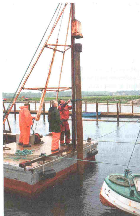
De frivillige har arbejdet intensivt i den forgange weekend bl.a. med at banke nye stolper ned på bådpladserne. Fotos: Poul Erik Bilstrup
